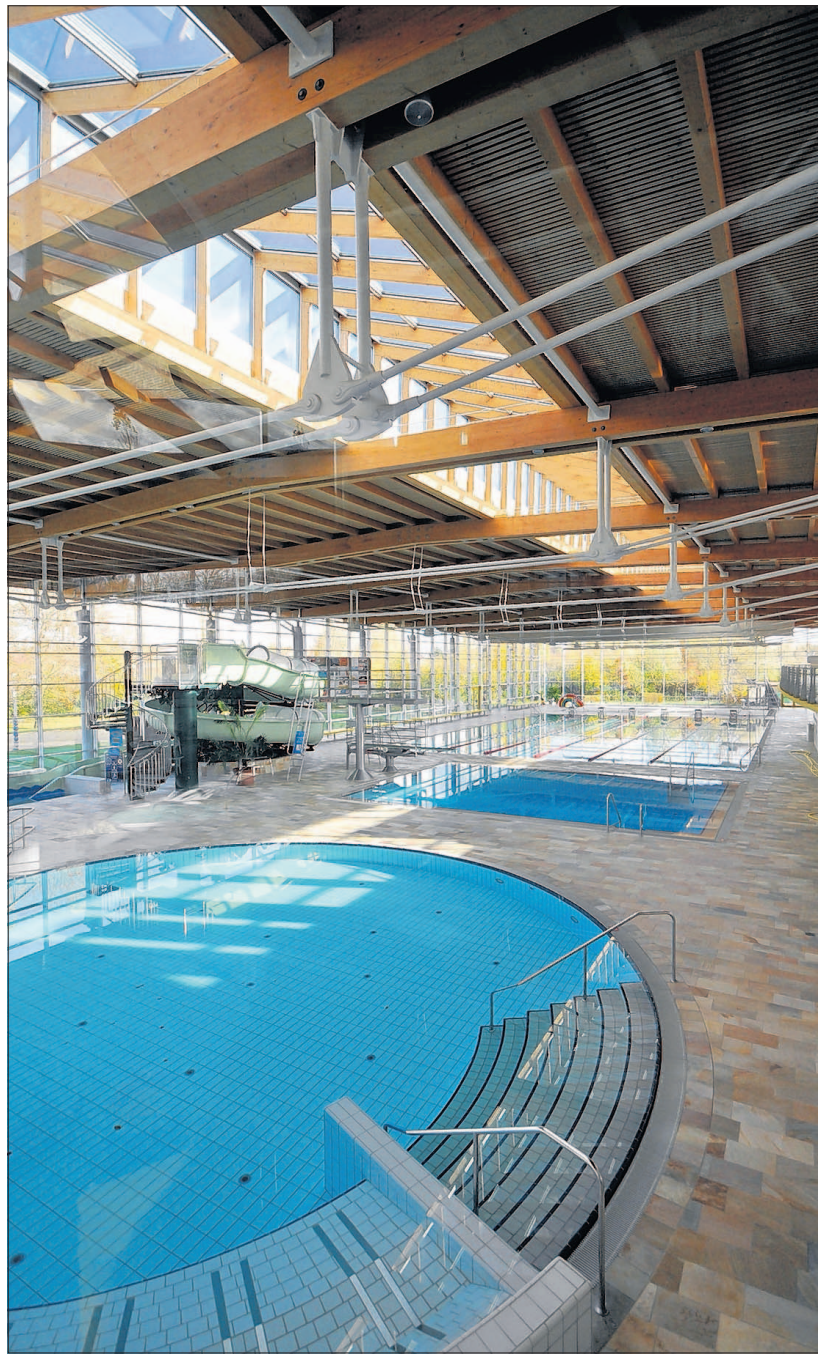
Verwaist: Seit Donnerstag bleiben die Becken des Greifswalder Freizeitbades wegen Einsturzgefahr des Daches ohne Besucher. Foto: Peter Binder
